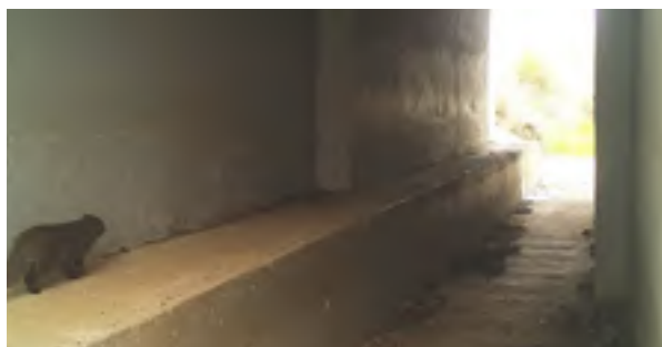
Carnívoros selvagens a utilizar os passadiços de fauna em Passagens Hidráulicas e Obras de Arte (fonte: Universidade de Évora)
