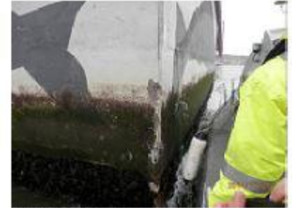
PONTO DE COLISÃO PC.2 VISTA GERAL
