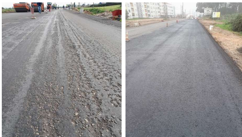
Figura 9. Desagregação superficial da camada reciclada aplicada com chuva (esquerda) e aspeto superficial adequado da camada aplicada sem chuva (direita) após abertura ao tráfego
