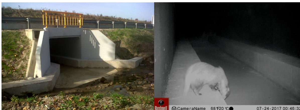
Fig. 19 – PH na EN18, ao km 74,800, com dois passadiços secos. Na fotografia da direita é possível visualizar um texugo a utilizar um dos passadiços (fotografia captada durante a monitorização da PH pela Universidade de Évora ao abrigo do Projeto LIFE LINES).
